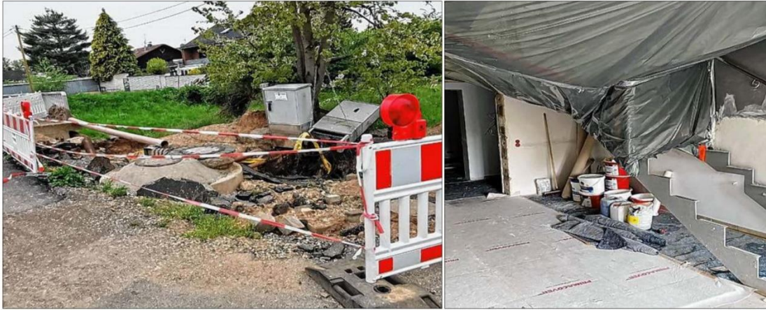
Auch ein Jahr nach dem verheerenden Hochwasser sind viele Spuren der Katastrophe in Metternich noch sichtbar und viele Schäden noch zu beseitigen (Bild links). Auch Udo Becker, Vorsitzender des Vereins „Metternich hilft“, hat die Schäden im Untergeschoss seines Hauses noch immer nicht beseitigen können.
